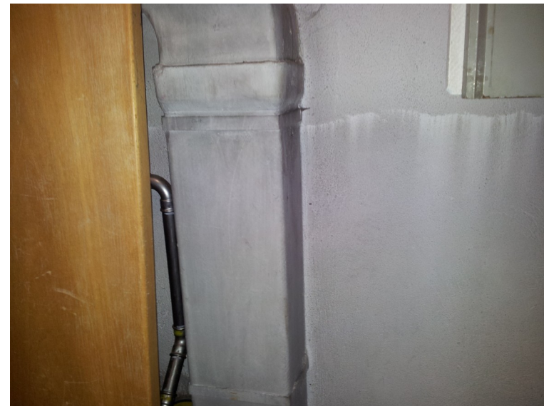
Lüftungskanal aus Asbestzement im Heizraum
