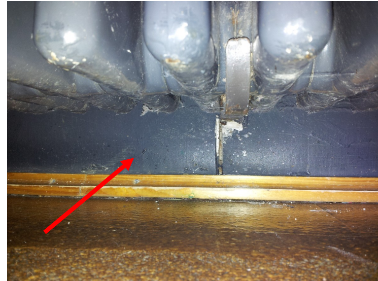
Abdeckung hinter der Heizung, Promabest
