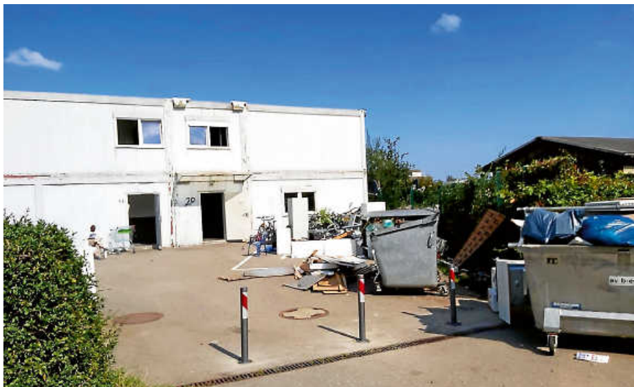
Die Unterkunft in der Brunnwiesenstraße ist in schlechtem Zustand.
